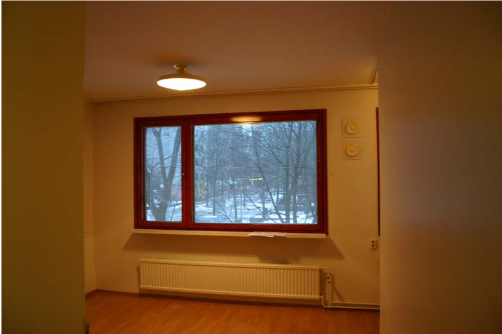
Kuva 18. Asuinhuoneen olohuoneen valaistusvoimakkuus ei ole riittävä. Katto ja seinät ovat hämärät.
