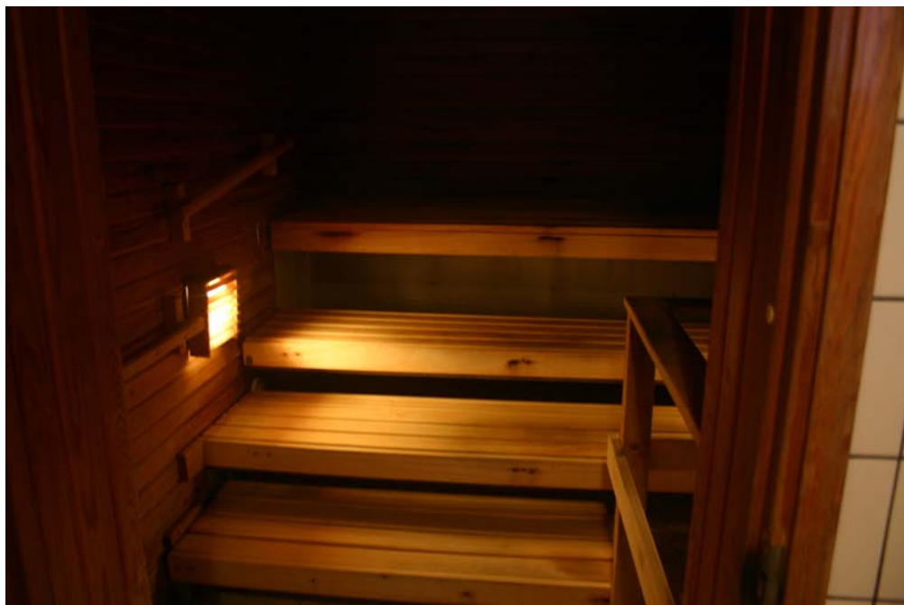
Kuva 21. Saunan valaisin valaisee hyvin alalauteen ja portaat, vaikka saunan yleisilme on hämärä.
