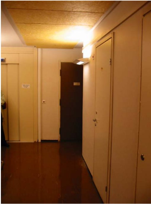
Kuva 28. Käytävän uusi valaistus. Käytävässä on käytetty kolmea kappaletta 2*55W epäsuoria seinävalaisimia.
